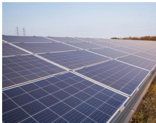
Centrale au sol
